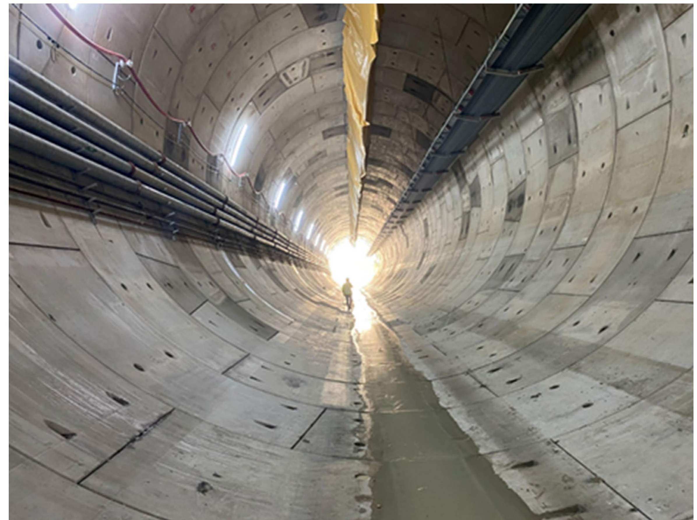
Linha 6 do Metrô em São Paulo, com 15,3 km de comprimento, com 15 estações capazes de servir 600.000 passageiros por dia
